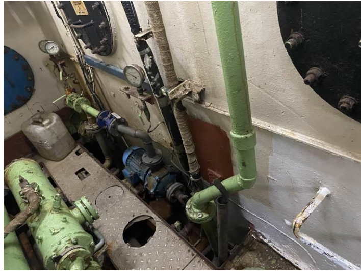
Sistema para tratamento de esgoto sanitário.
