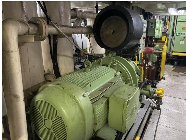
1 compressor de granel seco com pressão de trabalho de 6 bar e vazão de 25 m 3 /h – desativado.
