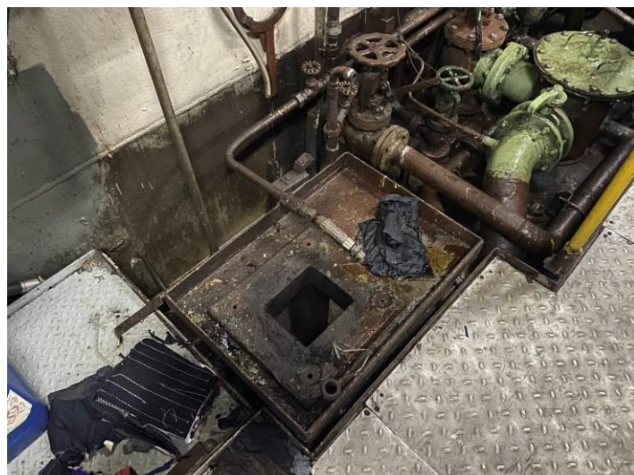
1 purificador de óleo Diesel Alfa Laval – Faltando.
