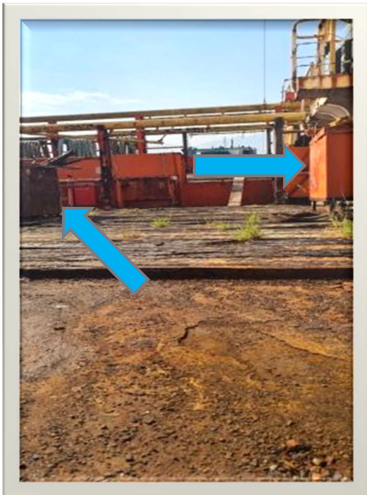
CAÇAMBAS DISPOSTAS NO CONVÉS COM MATERIAIS DETERIORADOS . PISO DO CONVÉS SE DESFAZENDO DEVIDO A CORROSÃO
