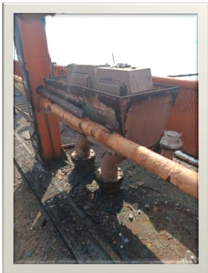
ESTRUTURAS E TANQUES ANTI POLUIÇÃO NO CONVÉS DA EMBARCAÇÃO EM PROCESSO AVANÇADO DE CORROSÃO.
